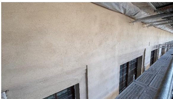
Kuva 2. Rappauksia Mannerheimintien julkisivulla.
