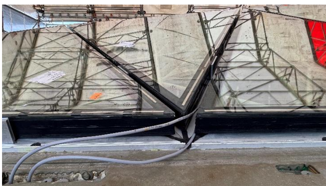
Kuva 4. Lämmityskaapeleita lasien välissä.
