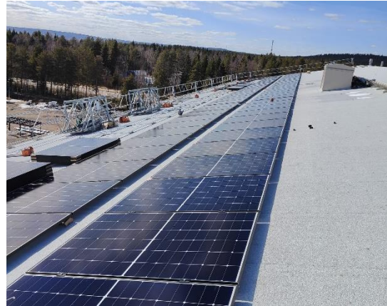
Kuva A-lohkon aurinkopaneeleja
