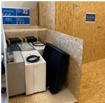
Kuva 5. Ilmankostuttimia ja kuivattimia.
