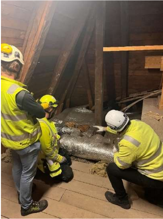
Kuvassa: mittamies Tapio Paunila, työnjohtaja Mirko Kauhanen ja aluevastaava Erno Immonen selvittävät talotekniikkareittejä.
